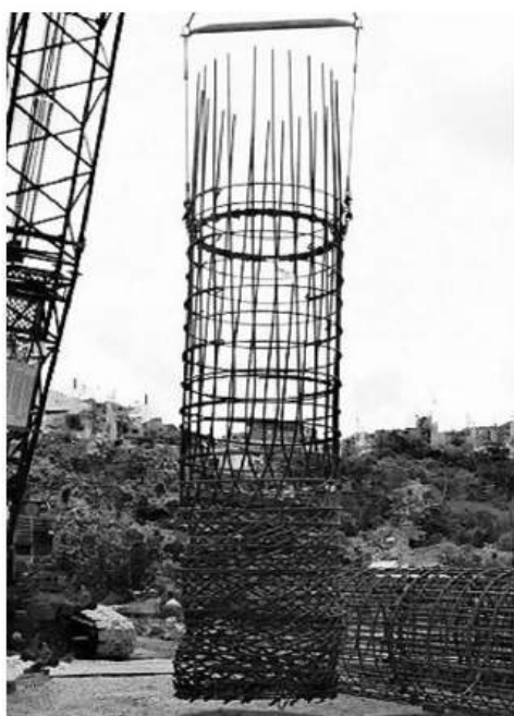
図-2 鉄筋かごの座屈事例①
